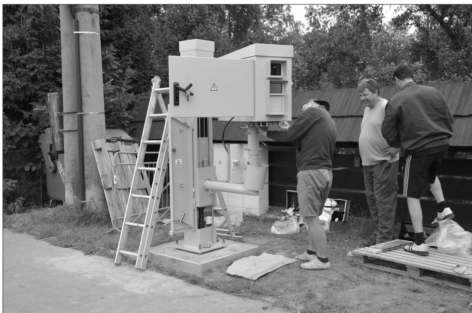
V posledním červnovém týdnu byl na ulici Záhumenní instalován nový radar, který snímá rychlost projíždějících vozidel v obou směrech. Až do konce července bude ve zkušebním provozu.
