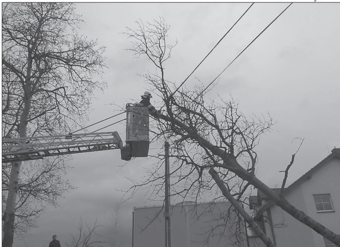
Po větrné smršti místní hasiči odstraňovali nejen stromy spadlé na objekty či komunikace, ale i na dráty elektrického vedení. FOTO: JSDH KOPŘIVNICE
