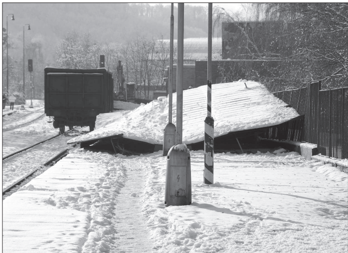
Ocelově zastřešení nástupiště z roku 1982 měla firma postupně odstranit. Po začátku prací se ale celá konstrukce nekontrolovaně zřítila.
