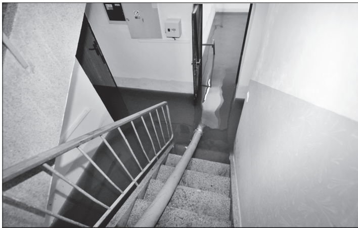
V Kopřivnici byly nejčastěji vytopené sklepy obytných domů, v některých byl až jeden a půl metru vody.
