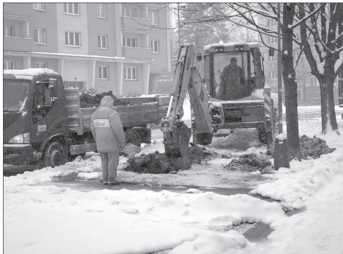
Jedna z havárií na vodovodním potrubí před týdnem zaplavila vodu také jednu z komunikací ve městě na ulici Obránců míru. FOTO: DAVID MACHÁČEK
