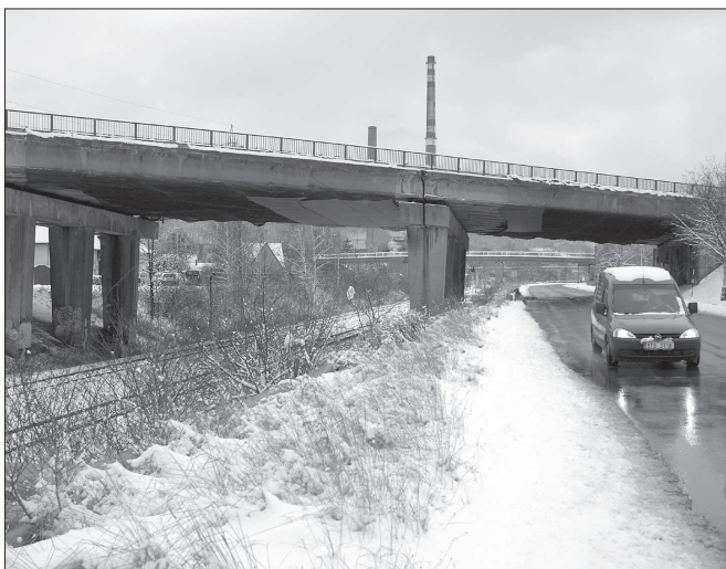
Most přes nadezd a místní komunikace v Kopřivnici se letos dočká rozsáhlé rekonstrukce. Stav mostu není dobrý a už nyní je opatřen ochrannými sítěmi. FOTO: DAVID MACHÁČEK
