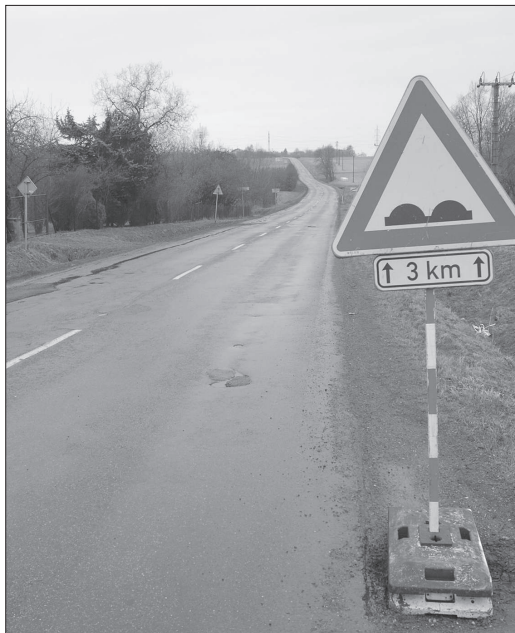
Kdy se začne s opravou silnice na Novém Jičíně, se zatím neví. Řidiči při jízdě klidně, aby se vyhnuli díram v komunikaci. FOTO: DAVID MACHÁČEK
