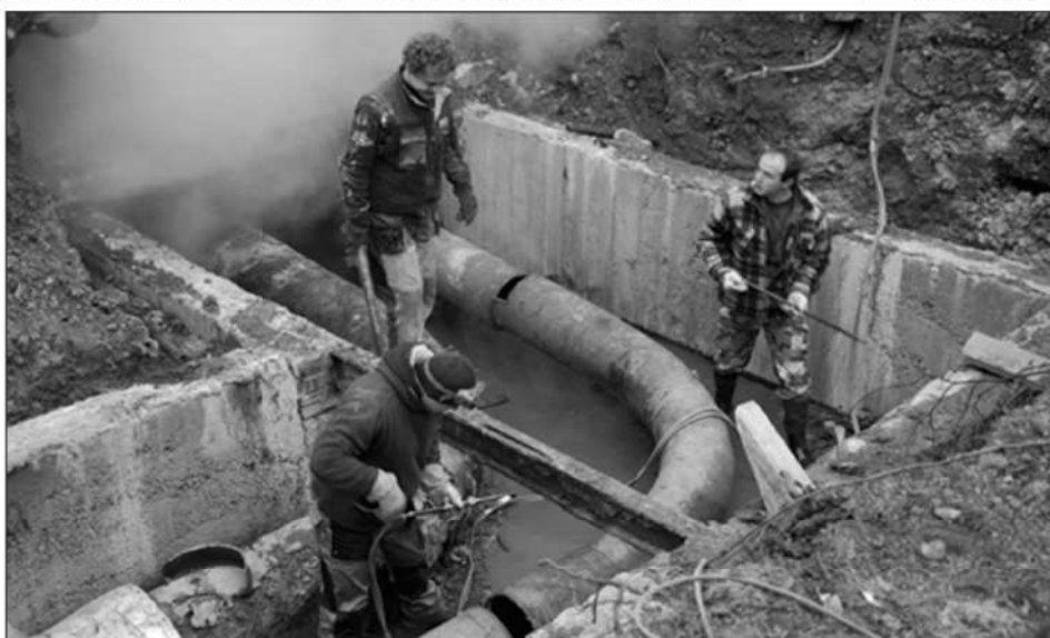
Část Kopřivnice napojená na systém centrálního vytápění byla téměř celou sobotu bez tepla a teplé vody. Důvodem byla oprava havárie na jednom z hlavních horkovodních potrubí.
