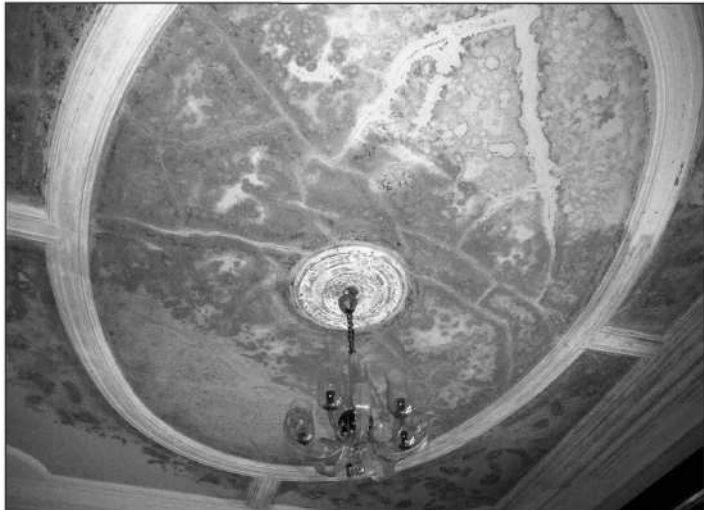
Strop v jednom z reprezentativních sálů objektu bývalého Závodního klubu je značně poničený vlhkostí. Problémy s hydroizolací jsou i v suterénu budovy.
