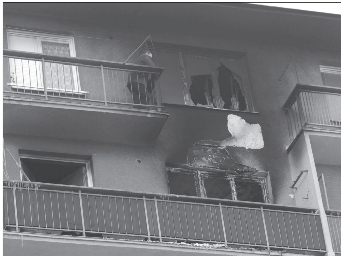
Poškozená okna dvou bytů v panelovém domě na ulici Dukelské. Oheň vypukl uprostřed noci v šestém patře sedmipodlažního domu.
