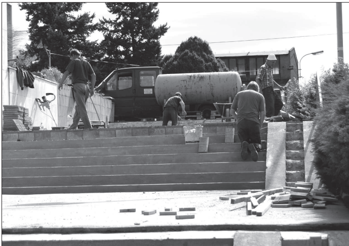
Opravu schodů v centru města prodloužil a prodražil špatný stav původního podkladního betonu. Oprava by měla skončit do poloviny září.
