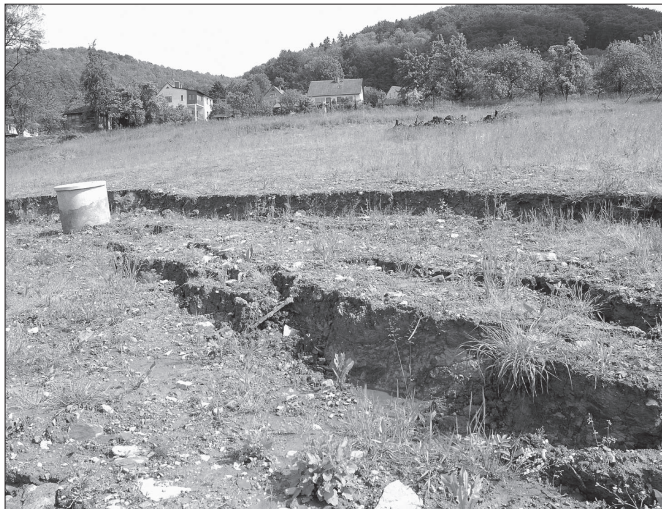
Masiv nedávno navezené zeminy v lokalitě za Farskou zahradou ve Štamberku se utrhlo po vydatných deštích v polovině května. Se sanací se čeká na lepší počasí. FOTO: DAVID MACHÁČEK
