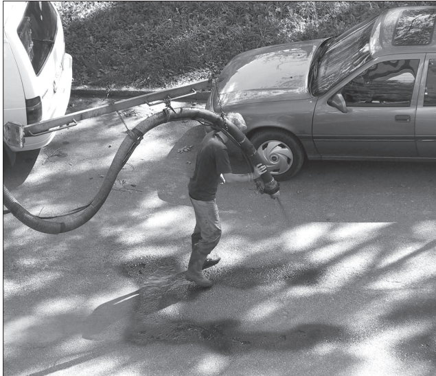
Většina peněz na opravy místních komunikací ve městě včetně místních částí už byla letos vyčerpána. Z důvodu krize byly seškrtnuty finance i na tyto práce. FOTO: DAVID MACHÁČEK
