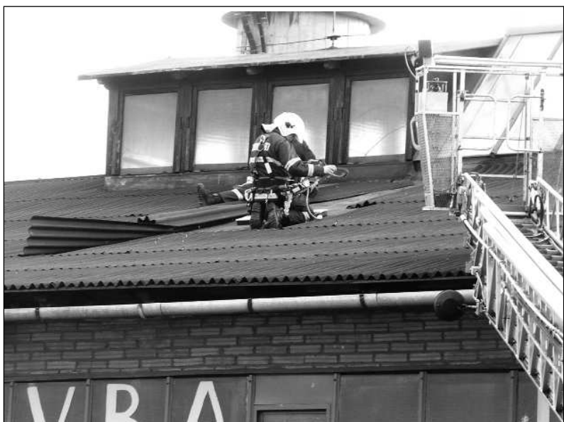
Jeden z výjezdů k odstranění škod větrné smrště byl k objektu na ulici Štefánikovu, kde hasiči provizorně opravili střechu. FOTO: HZS TATRA KOPŘIVNICE
