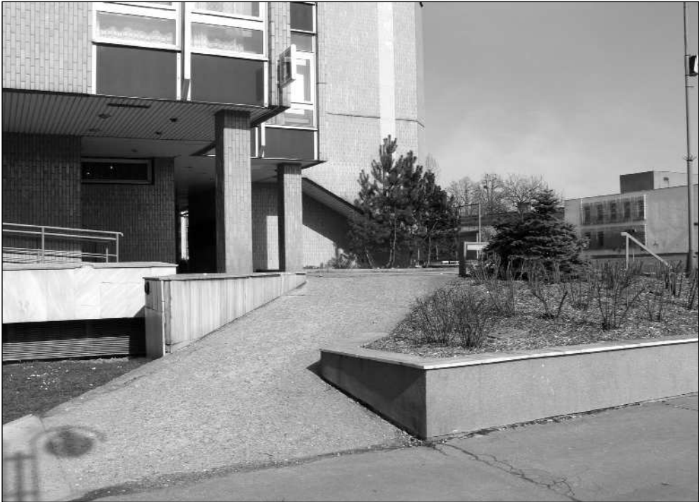
Na opravu dlouho kritizovaného stavu nájezdu by mělo dojít o prázdninách.
