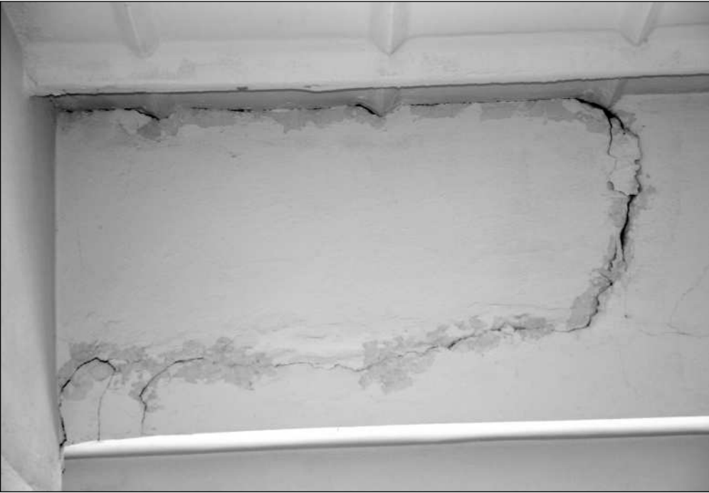
Praskliny ve zdech tělocvičny a těžnoucí sněh na střeše. To byl důvod, proč se ředitel ZŠ dr. Milady Horákové rozhodl dát žákům volno. Podle statika oprávněně.
