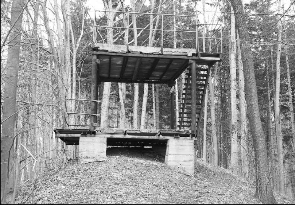
Havarijní stav Bezručovy vyhlídky na Brdech nutí město uvažovat o jejím zajištění. Ve hře jsou jak varianta demolice, tak rekonstrukce.
