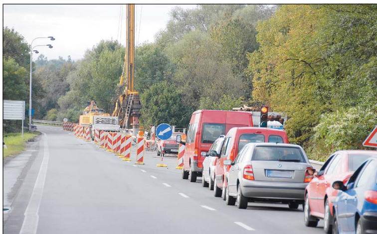
Silnice poškozená povodní prochází rozsáhlou opravou. Až do konce října bude trvat omezení dopravy na silnici I/67 ve směru z Karviné do Českého Těšína ve zhruba stometrovém úseku poblíž městské části Karviná-Louky. Zdejší vozovka byla poškozena během letošní květnové povodně. Oprava, která je v tomto úseku svedena do jednoho jízdního pruhu, je řízena kyvadlově pomocí semaforu.
