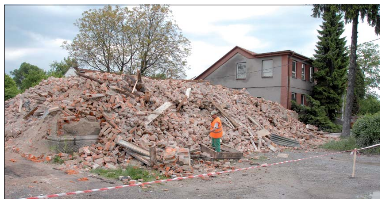
Pondělí 24. května – krátce po poledni je zprůjezdněna komunikace ve směru z Karvině na Český Těšín. Město shromažďuje průběžné informace o stavu objektů zasazených povodní a následných škodách. Zpřesňuje se také rozsah zasazených území v katastru města, je provedena první popovídní asanace poškozené budovy v levobřežní části Darkova.
