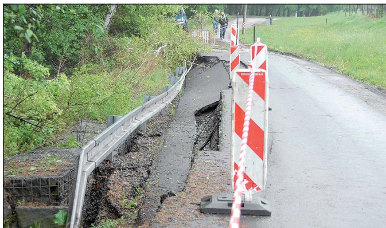
Na některých místech v Karvině jsou hlášeny sesuvy půdy. Nejkritičtější je situace v ulici Podlesí, kde voda podemlela příjezdovou komunikaci. Její část se následně sesunula, jak zachycuje fotografie ze středy 19. května.
