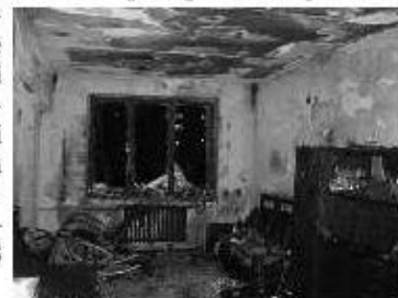
Obr. – následky požáru v bytové jednotce
