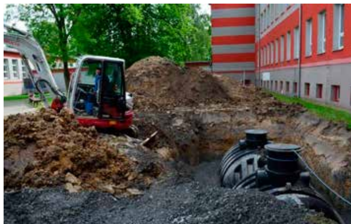
Nádrže na dešťovou vodu jsou umístěné pod zemí.
