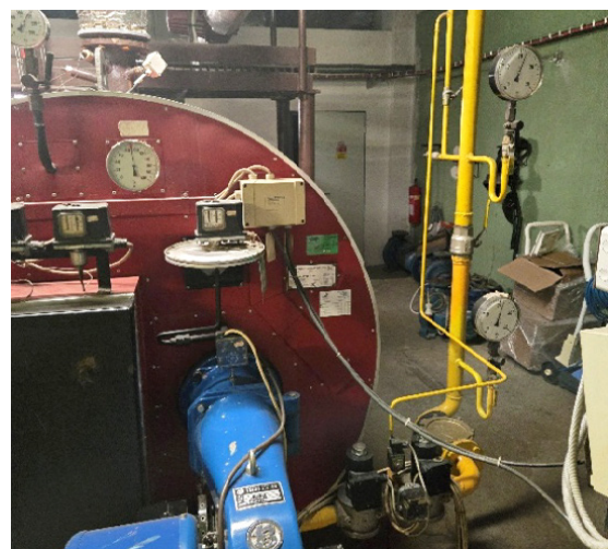
Původní plynový kotel
