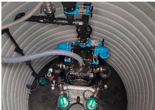
Technologie čerpací stanice.
