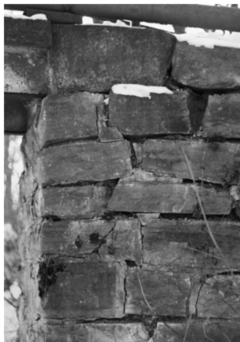
poškození lávky přes řeku v Rychalticích u fary
