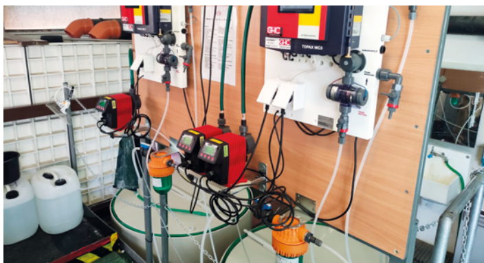
V květnu byl ve strojovně městského koupaliště instalován systém automatického dávkování chlóru.
