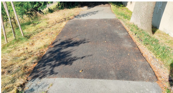
Před začátkem hlavní letní sezóny byly opraveny největší nerovnosti na cyklostezce kolem řeky Moravice.
