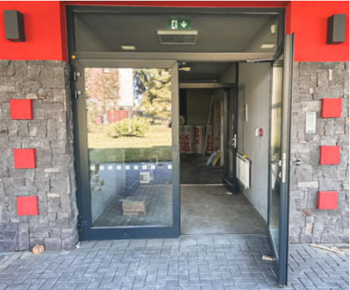
Vstupy do tělocvičny jsou nově vybaveny protipovodňovými zábranami.
