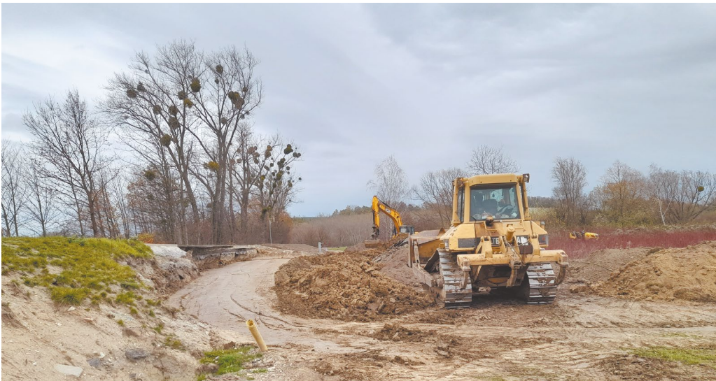
Povodně poškodily i hráz Hlučinského jezera. Na její opravě se pracuje. Foto: Regina Janošová
