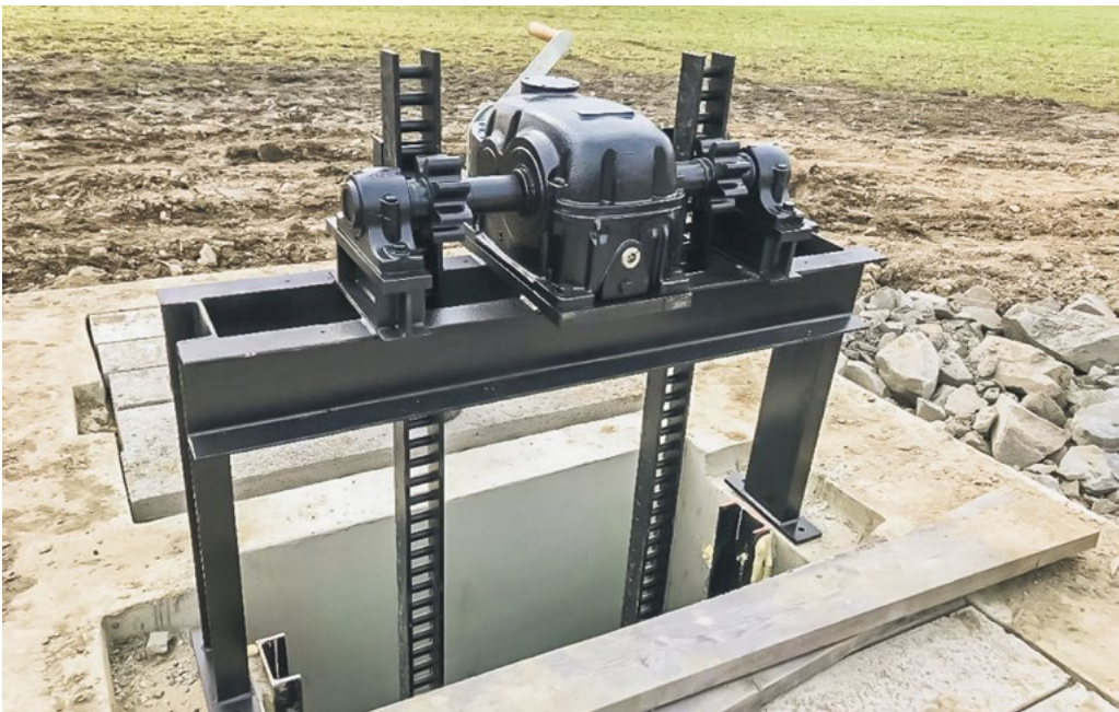
Výpustný objekt - technologie.
