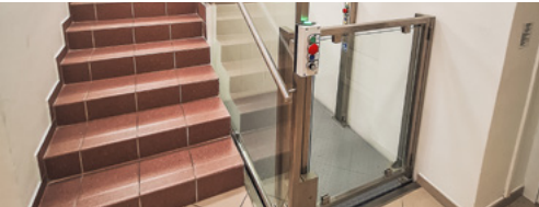
Plošina k cestovním a občanským dokladům.
