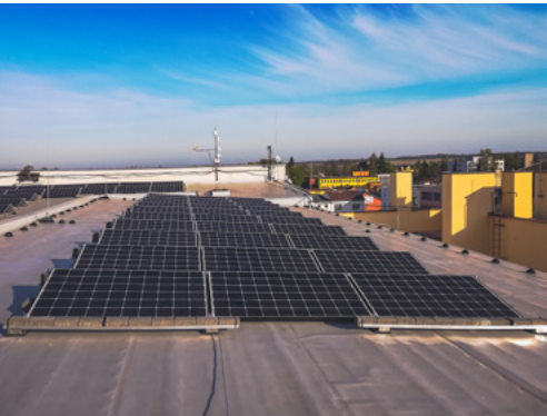
Fotovoltaické panely na střeše městského úřadu.
