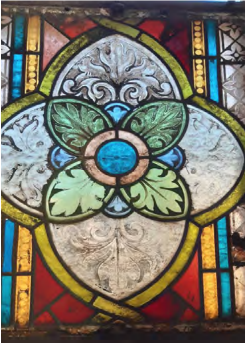
Okno před restaurováním.
