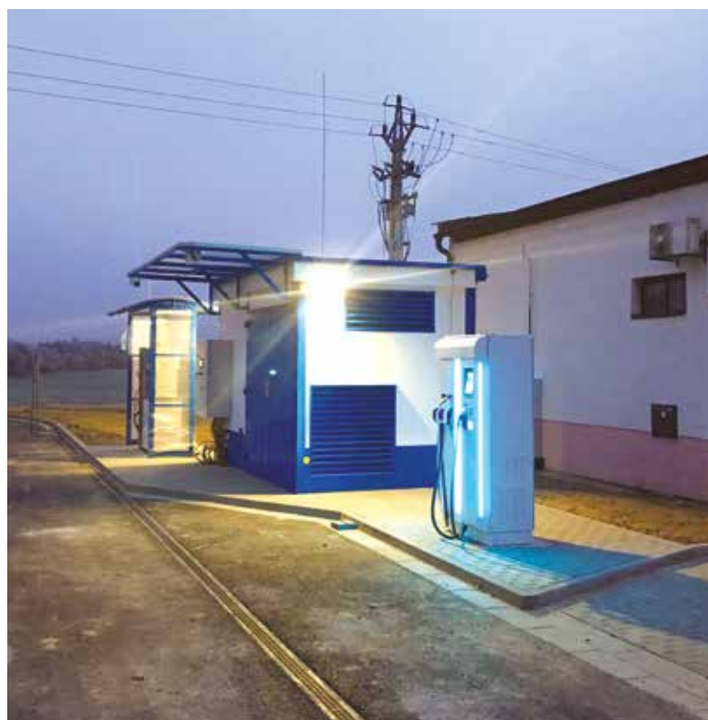
Nová plnicí stanice v ulici Čs. armády.
