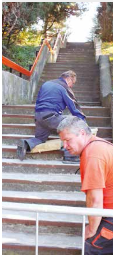
Schodiště u kulturního domu se muselo opravovat dvakrát po sobě.
