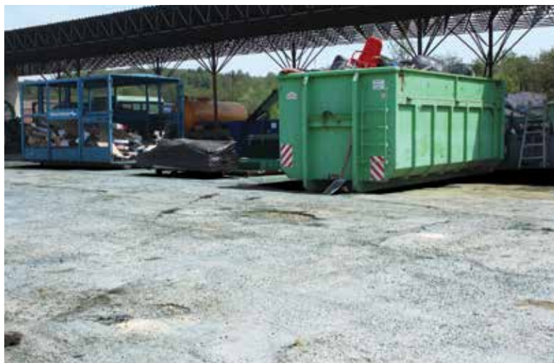
Před opravou byl povrch v areálu sběrného dvora plný děr.
