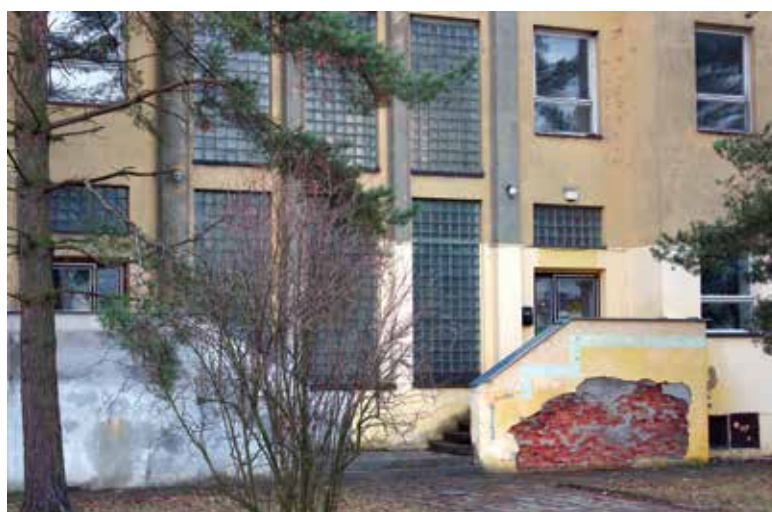
Budova bývalé mateřské školy na Rovninách od roku 2012 chátrá.
