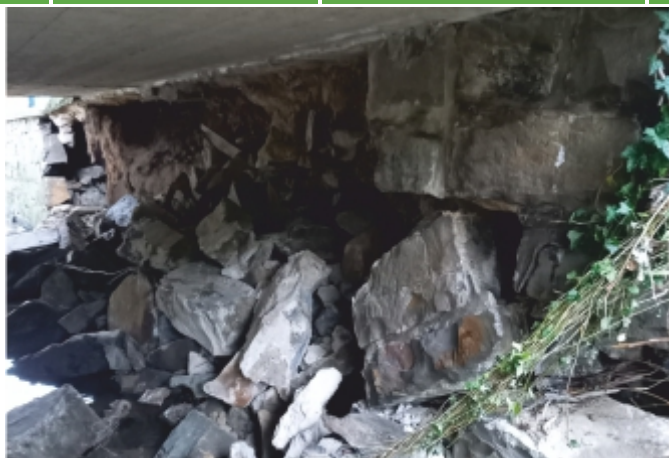
Podemletý most ul.Sokolská
