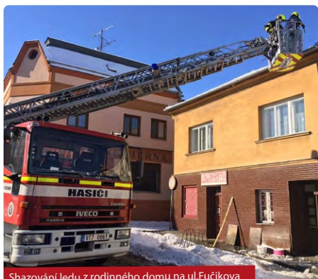
Shazování ledu z rodinného domu na ul. Fučíkova
