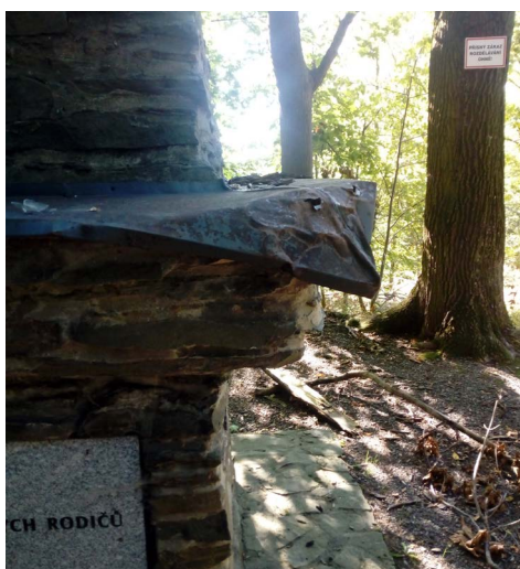
Stříbrná svatba, detail poškození
