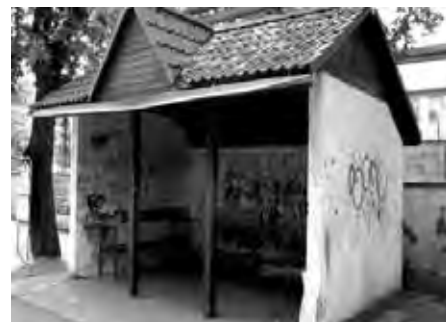
Zastávka na autobusovém nádraží ve Fulneku před opravou
