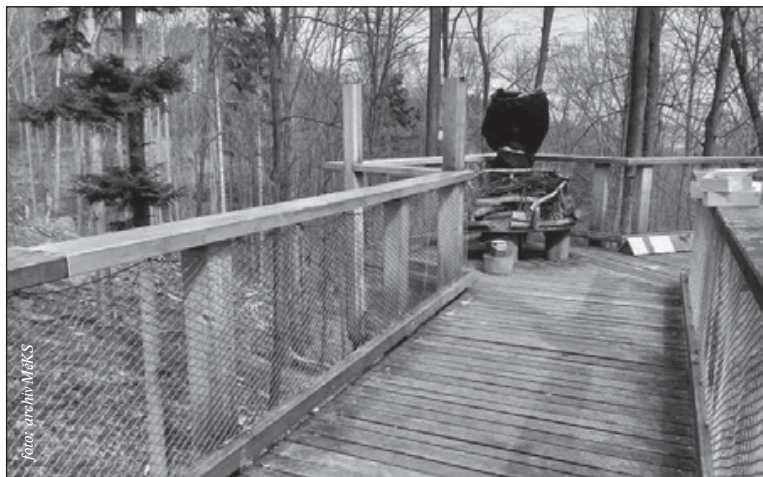
V těchto dnech byly vyměněny části vzdušného chodníku, který v lednu poškodily padající stromy, vyvrácené prudkou vichřicí
