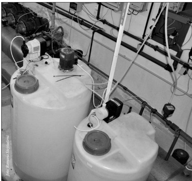
Zázemí akvaparku s barely na chemikálie a dávkovací čerpadla pro úpravu bazénové vody
