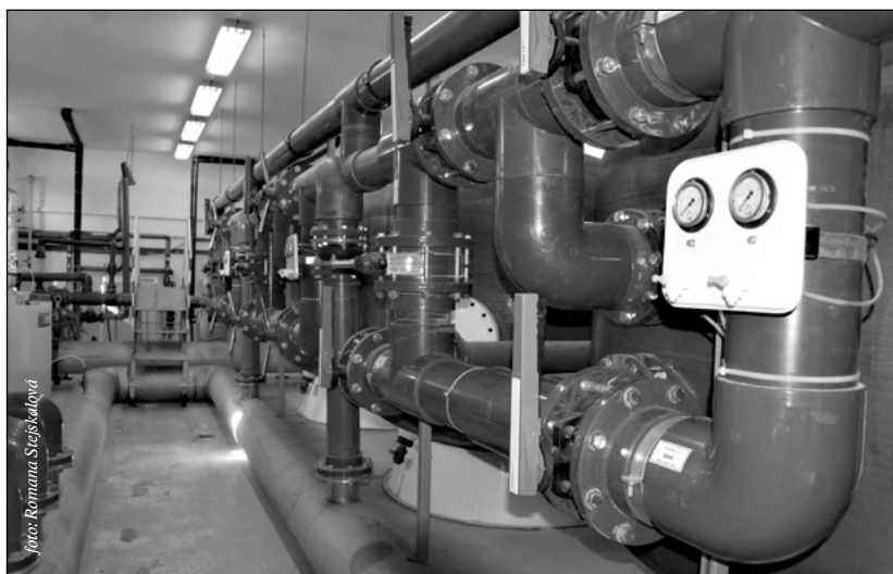
Zázemí akvaparku. Tlakové pískové filtry pro úpravu bazénové vody
