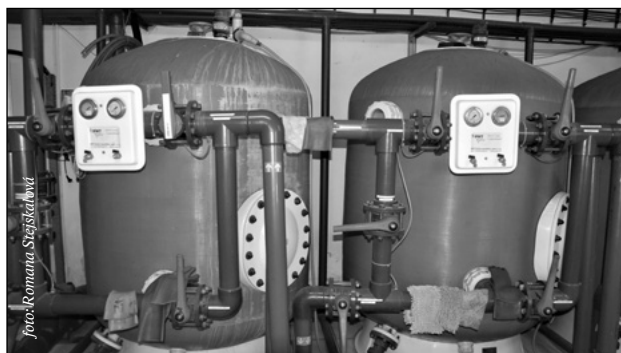
Pohled na tlakové pískové filtry v prostorách zázemí krytého bazénu
