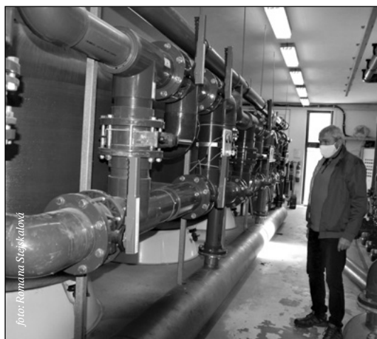
Rozvod potrubí pro pískové filtry
