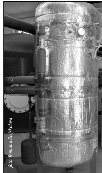
Kotel a dvě ze šesti tepelných čerpadel
