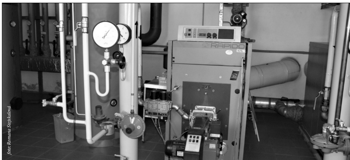
Tři zásobníky krytého bazénu /po 500 l/ na teplou vodu a dva kotle na ohřev teplé užitkové vody
