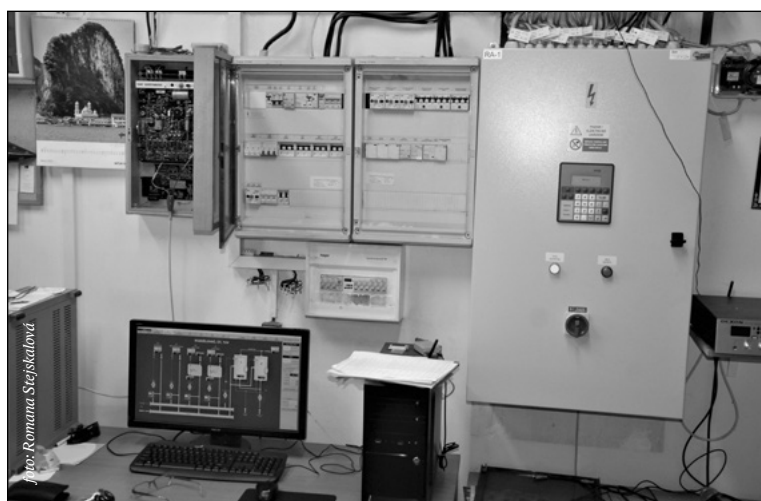
Srdce krytého bazénu: Elektrické zařízení včetně počítačového programu pro řízení plynové kotelny a ohřev bazénové vody
