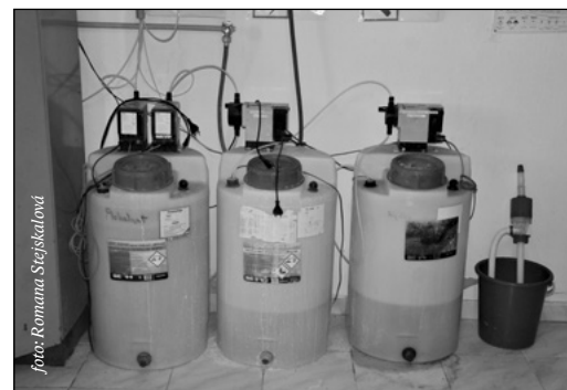
Nádoby na chemii a dávkovací zařízení na úpravu vody
