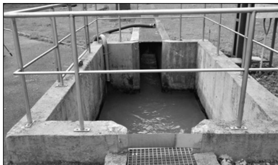
Nátok odpadní vody do areálu čistírny a lapák štěrku odstraňující největší nečistoty
