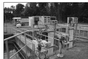
Čidla monitorující průtok vratného kalu v čistírenském procesu
