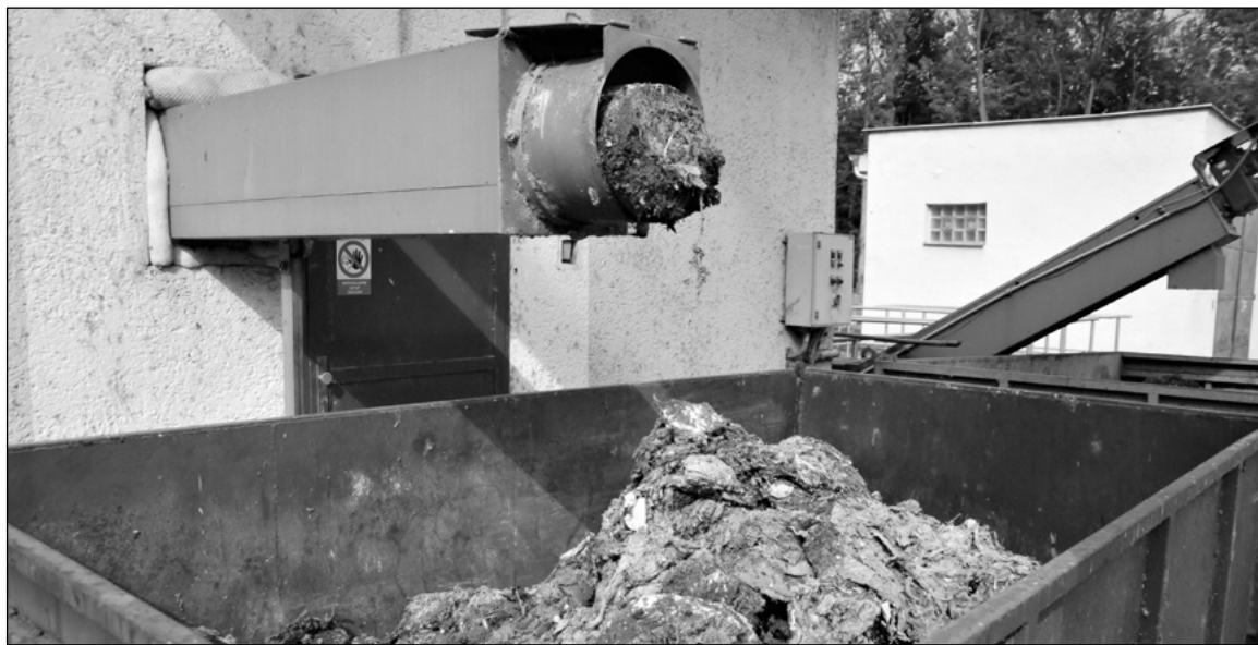
Nečistoty větších rozměrů se nazývají shrabky. Na snímku dopravník shrabků v mechanické části čistírny
