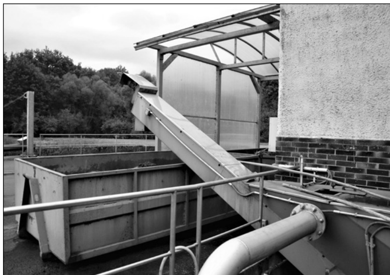
Lapák písku se separátorem odstraňuje z odpadní vody větší nečistoty
