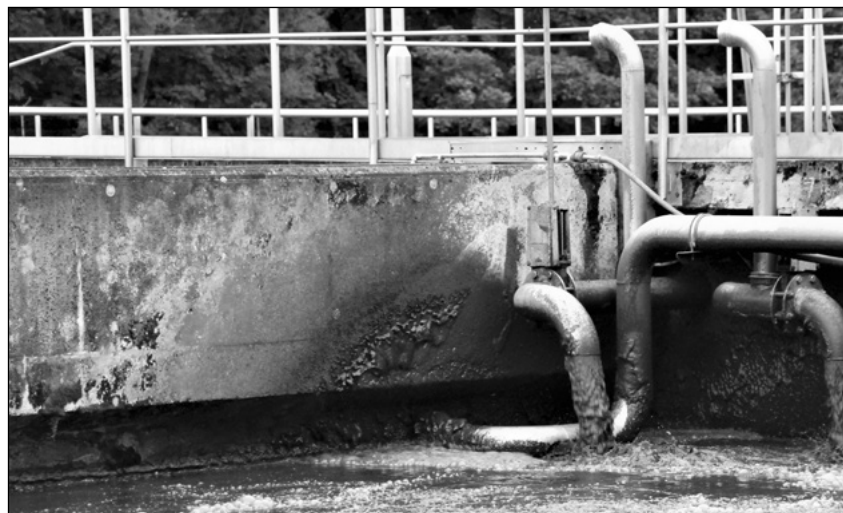
Regenerace aktivovaného kalu. Sem se vrací kal z dosazovacích nádrží a provzdušňuje se, aby byl připraven k dalšímu čištění odpadní vody
