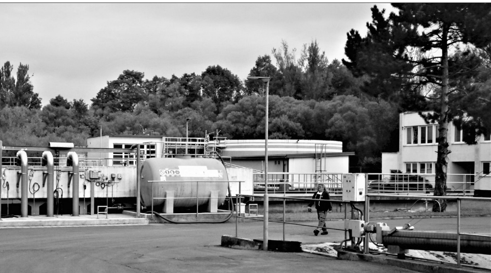
...ní vodu do biologické části čistírny. V nádrži je chlorid železitý sloužící k odstranění fosforu z odpadní vody
