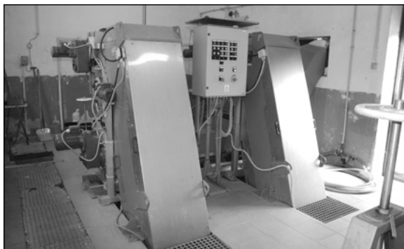
Jemné česle jsou součástí mechanické části čistírny
