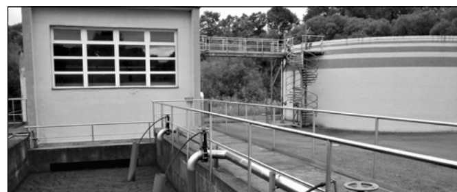
Zahušťovací nádrž použitého kalu. Ten se následně čerpá do uskladňovací nádrže (vpravo na snímku), poté směřuje do odstředivky k odvodnění
