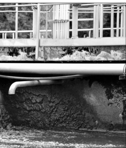
...mohl být dále využit při procesu čištění v nádržích
