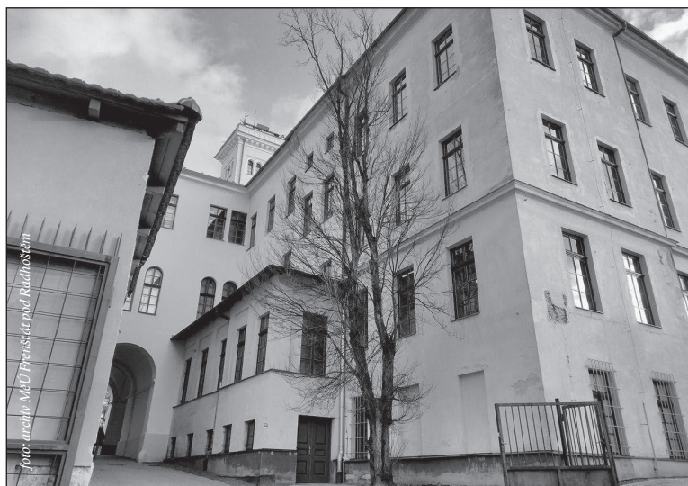
Historická část budovy radnice ve Frenštátě pod Radhoštěm – část fasády před opravou
