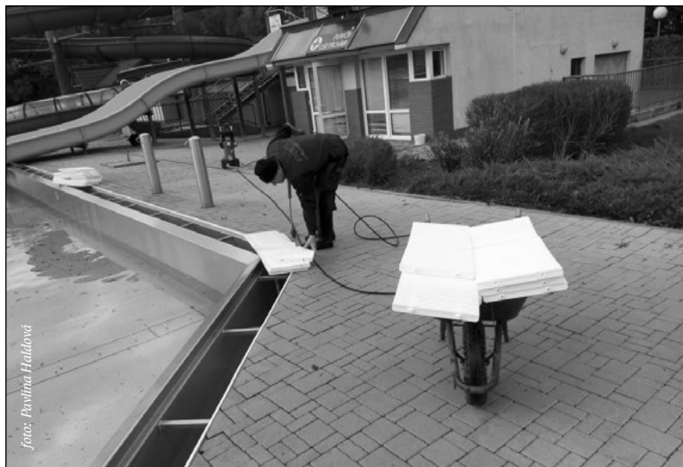
Letní sezona skončila. Aquapark se zazimuje, částečně se upustí voda, zajistí se čerpadla a vypne se elektroinstalace
