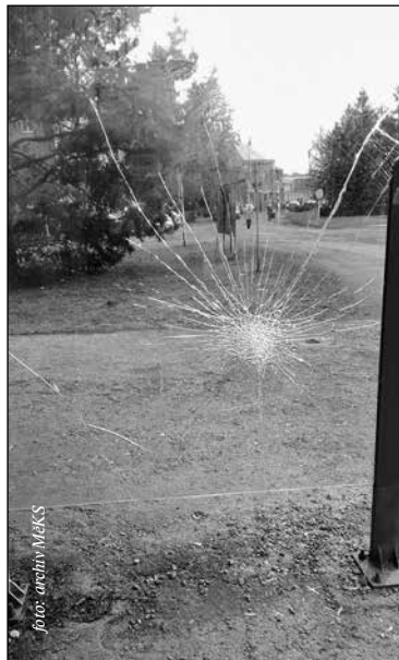
Rozbitá stěna autobusové zastávky
