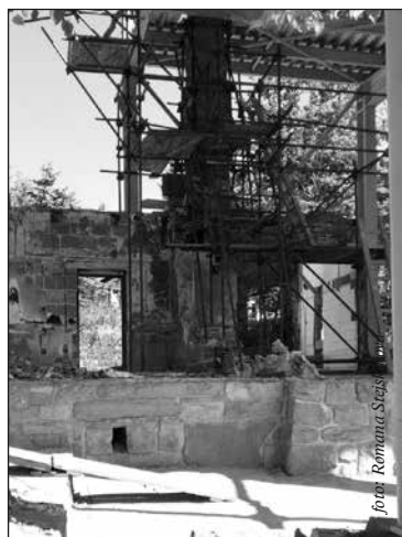
Z objektu se podaří zachovat jen malou část původních prvků
