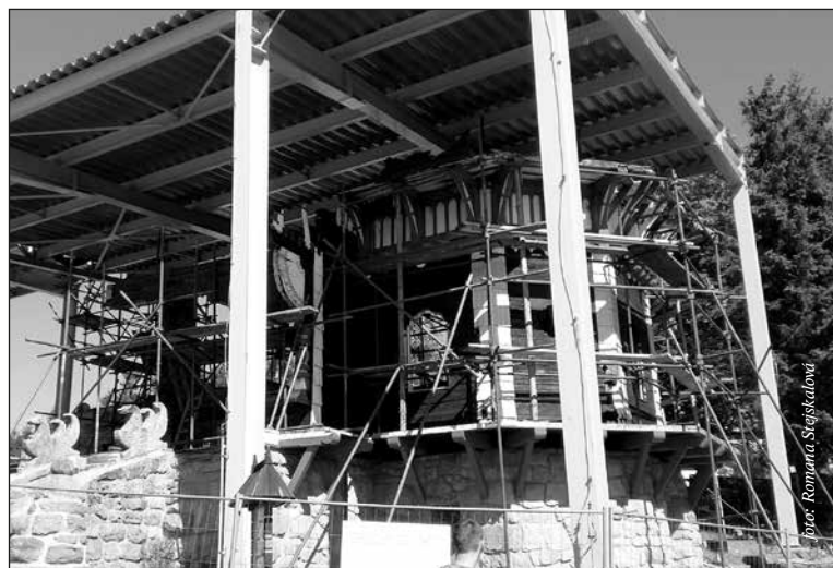
Řemeslníci se snaží z vyhořelého Libušína zachránit, co se dá
