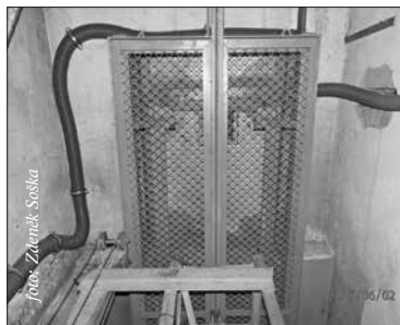
Část hlavního vedení přes jeviště
