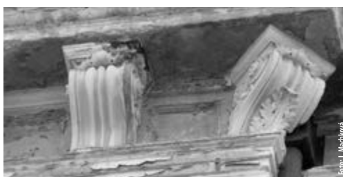
Hlavní římsa s balustrádou byla v havarijním stavu
