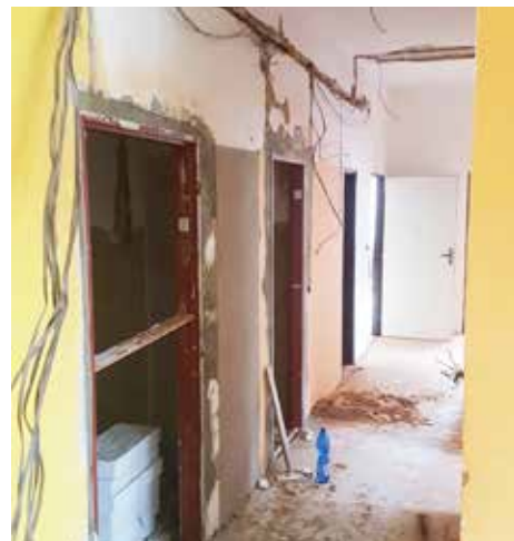
Během jarní vlny, když se zavřely školy a děti zůstaly v dětském domově, vrcholila v DD rekonstrukce elektroinstalace
