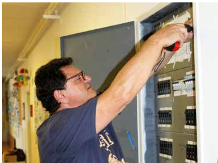
Elektrorevize školy zajišťuje firma REVIS ELEKTRO.
